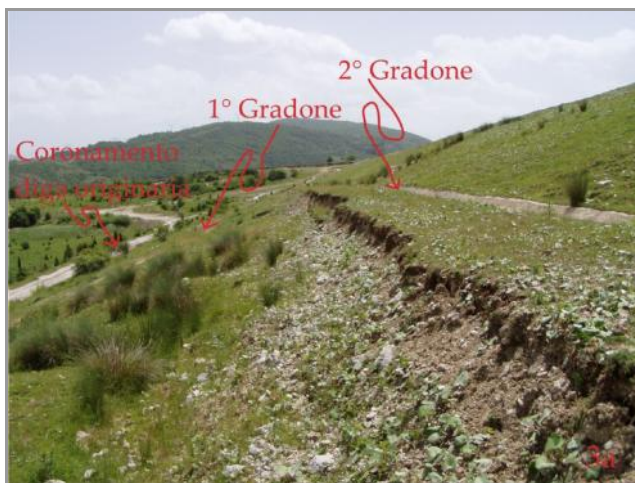
Figura 6 – Diga – Collassamento generale 2° gradone
