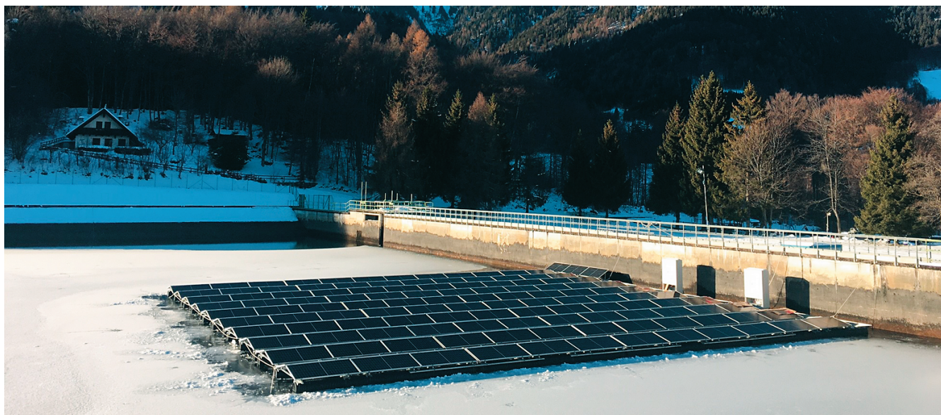
Impianto fotovoltaico flottante da 98,2 kWp realizzato presso l'invaso idroelettrico di "Bacino Dampone" nel Comune di Sella Giudicarie (TN) di Hydro Dolomiti Energia del Gruppo Dolomiti Energia di Trento.
